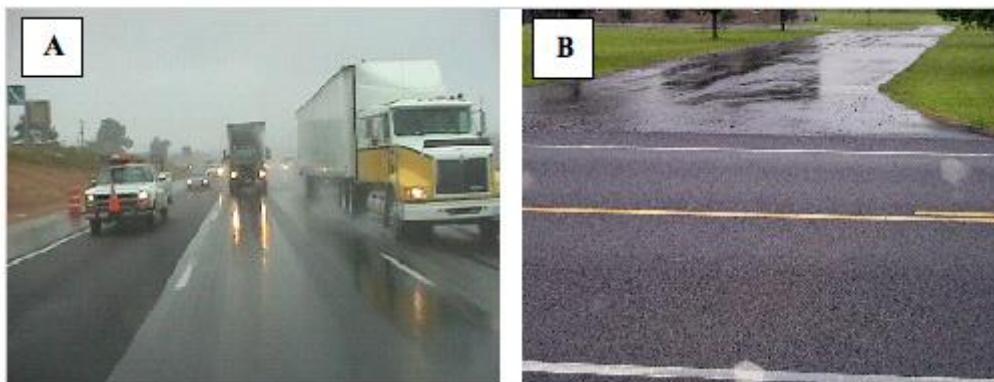
Soluzione Asphalt Rubber sulla IH35, San Antonio (Texas). Corsia drenante e corsia tradizionale (A); particolare della superficie finita (B).
